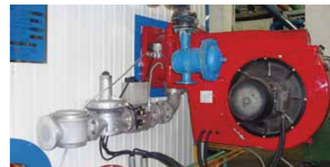
大庆油田采油八厂十吨HZJS16型燃烧器应用现场
